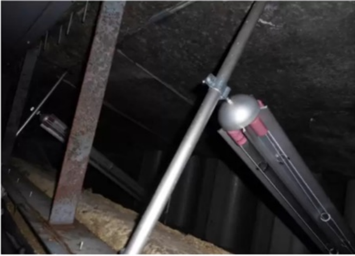
Instalación de un BioWall en los conductos
